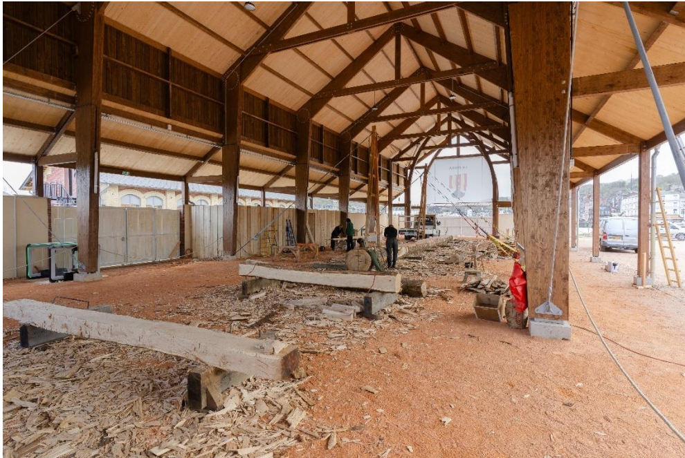
Reconstruction de la forge du chantier de La Mora à Honfleur © Fondation du patrimoine_MyPhoto
